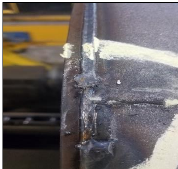
Figura 9. Defecto de soldadura por escurrimiento de vidrio.
