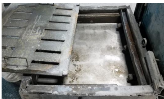
Figura 13. Tina del elevador de tanques arranque de turno.
