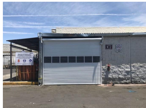
Figura 10. Puerta del almacén de residuos peligrosos con cortina enrollable.
